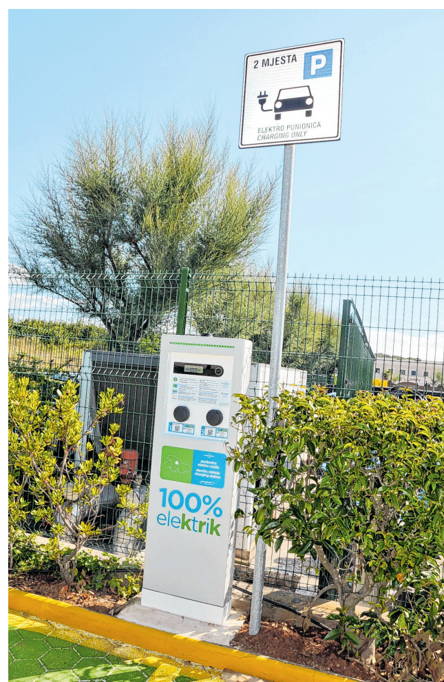
Punionicama elektrovozila davno instaliranim diljem Bodulije, uskoro bi se mogle priključiti i one namijenjene elektroplivilama što, među ostalim, potiče i projekt Deep Sea
